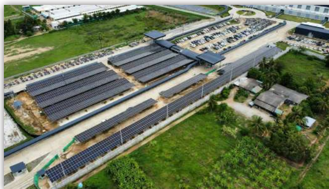
โรงฆ่าหมูสะแกและโรงงานปรงสุก สาขากาญจนบุรี (Solar Car Park)
